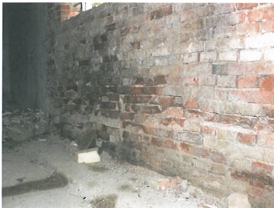
Obr. 5 – postupný rozpad cihel, na vnitřním líci se postupně odlupuje okrajová vrstva cihel
