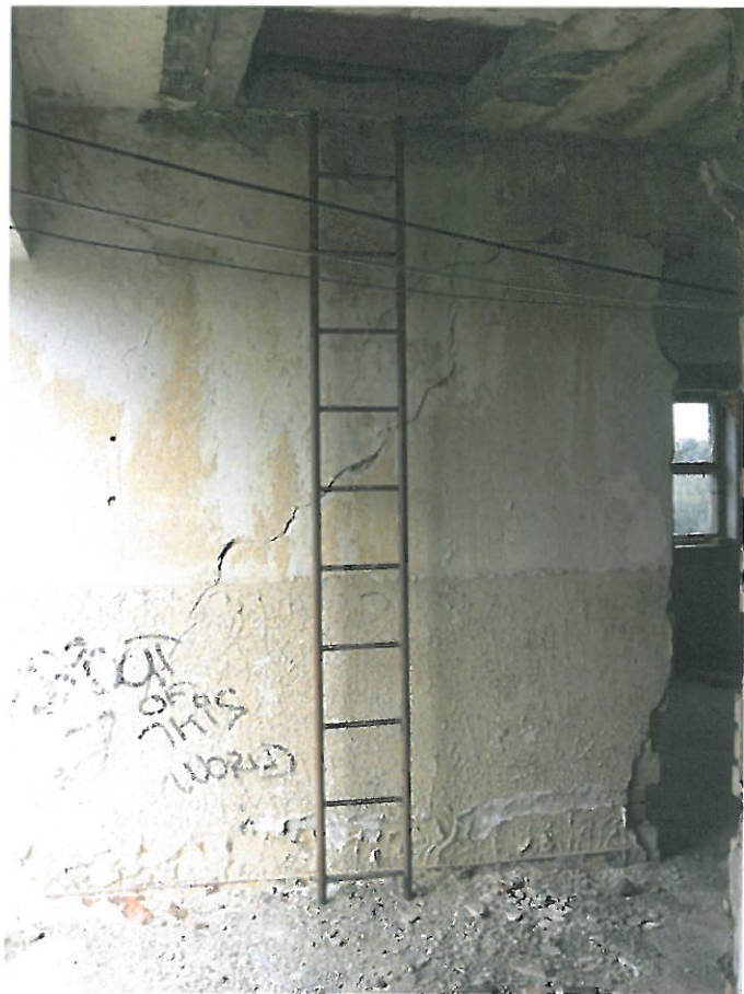
Obr. 12 – trhлина ve střední nosné stěně, zatékání přes střechu a poškození prefabrikovaných desek vlivem zatékání
