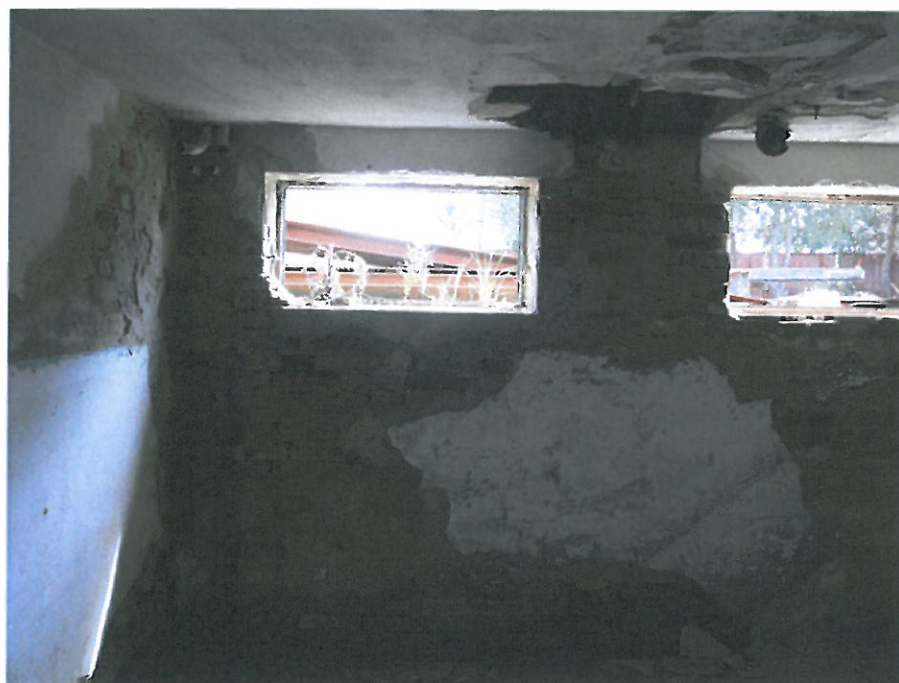
Obr. 3 – zdivo vykazuje velmi vysokou vlhkost a dochází k rozpadu cihel v obvodové stěně v suterénu
