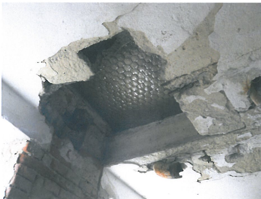
Obr. 9 – průrazy ve střepech jsou provedeny tak, že jsou přerušeny nosné stropní ŽB nosníky bez dalšího statického opatření
