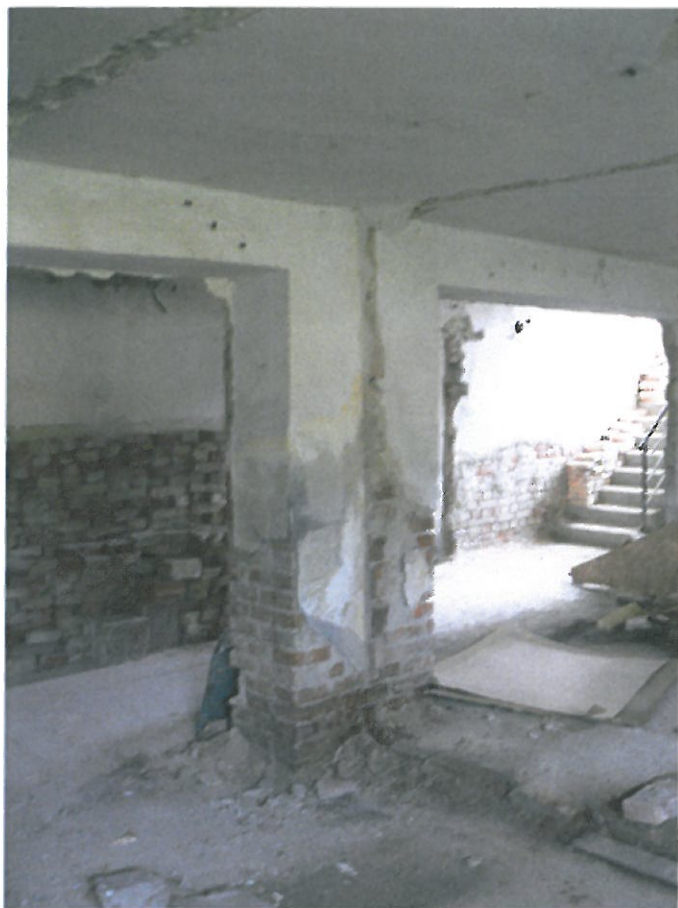
Obr. 10 – zdivo nosných pilířů ve spodní části degraduje vlivem vlhkosti a zmrazovacích cyklů
