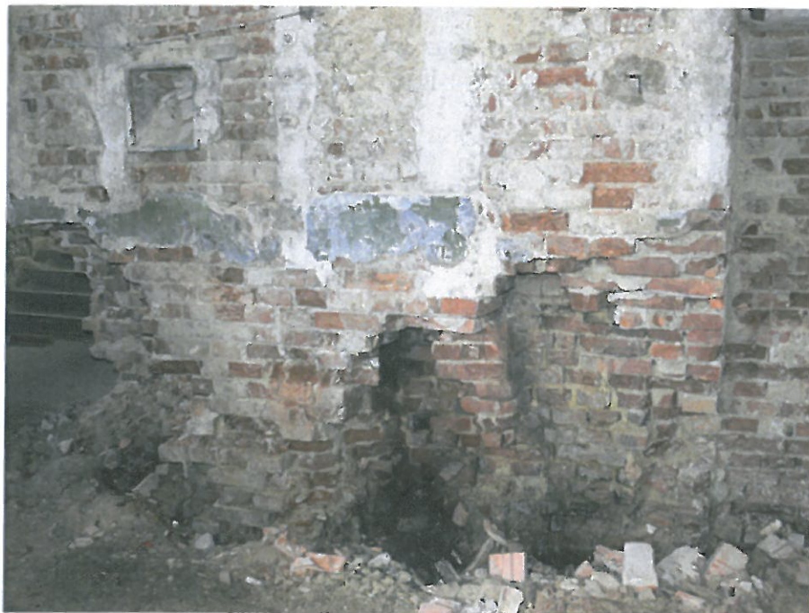
Obr. 6 – rozpadající se zdivo komínových průduchů, které jsou součástí vnitřní nosné stěny v suterénu
