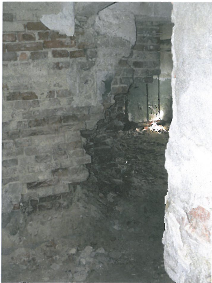
Obr. 4 – kaverna ve zdivu v suterénu v blízkosti komínových těles u střední nosné stěny
