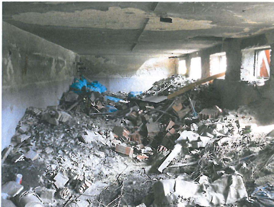
Obr. 8 – zasypaný prostor sníženého suterénu stavebním rumem a smetím
