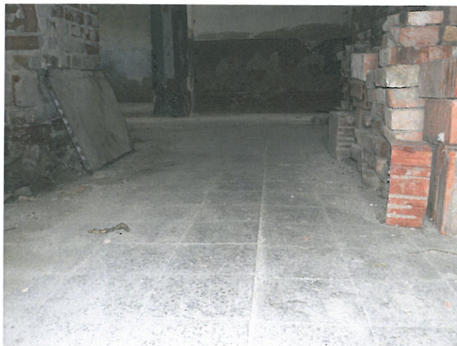
Obr. 7 – zakřivené podlahy na chodbě v suterénu
