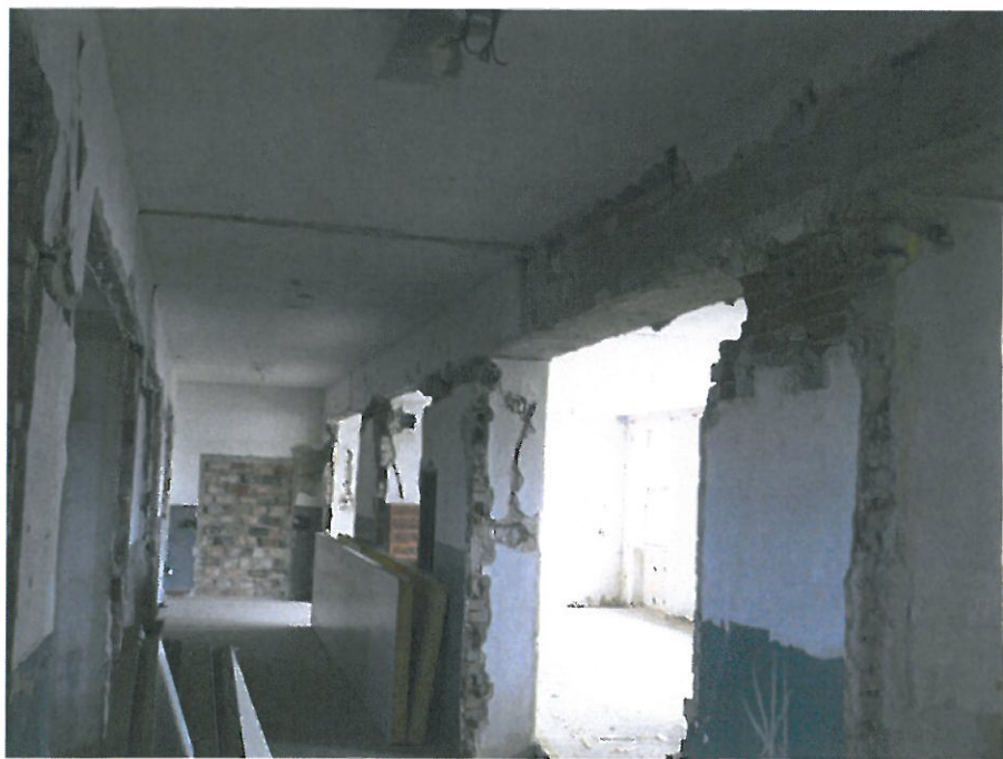
Obr. 13 – poškozené nosné vnitřní pilíře v 1. NP
